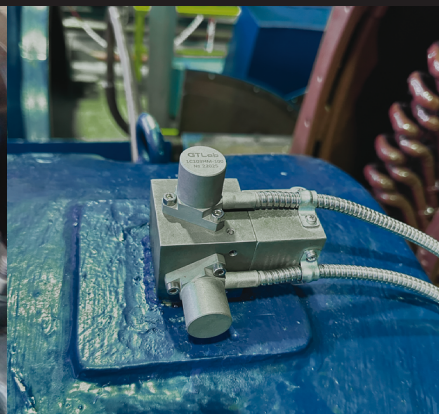
Установка акселерометров IC203NM-100 на электродвигатель и редуктор ГПА
